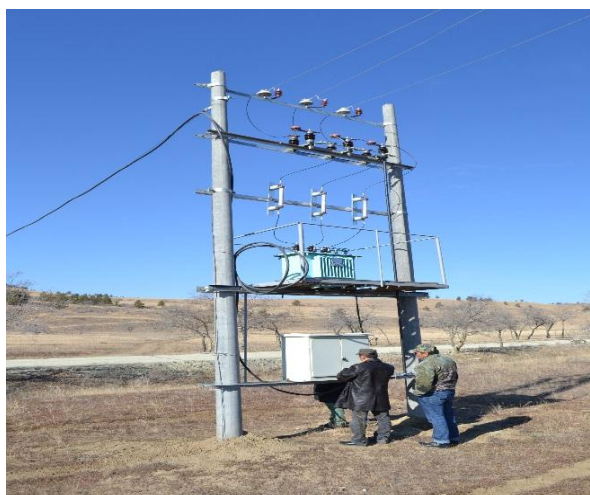
/Сумдын 0,4 кв-ын цахилгааны шинэчлэлт/
