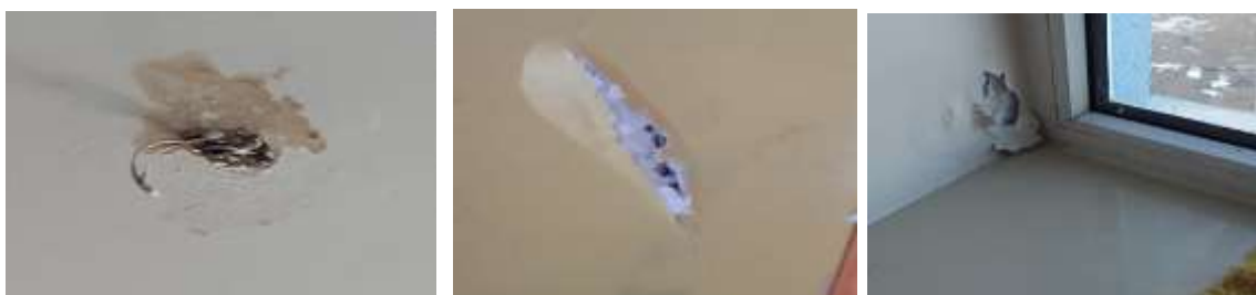
Дээврээс ус гоожсон, хана, цонхны хэсгийн замаск хуурч ховхорсон байдал
