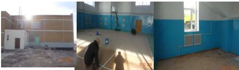
Зураг. гадна ханын барилгын булангийн хэсэгт заадас гарсан, дээврээс ус гоожсон, орчны тохижилт хийгдээгүй, гадна талбайн цемент хагарч бутарсан байдал
