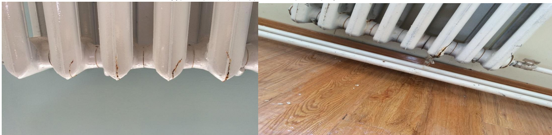
Дотуур байрны өрөөнүүдийн паар хагарч ус гоожсон байдал
