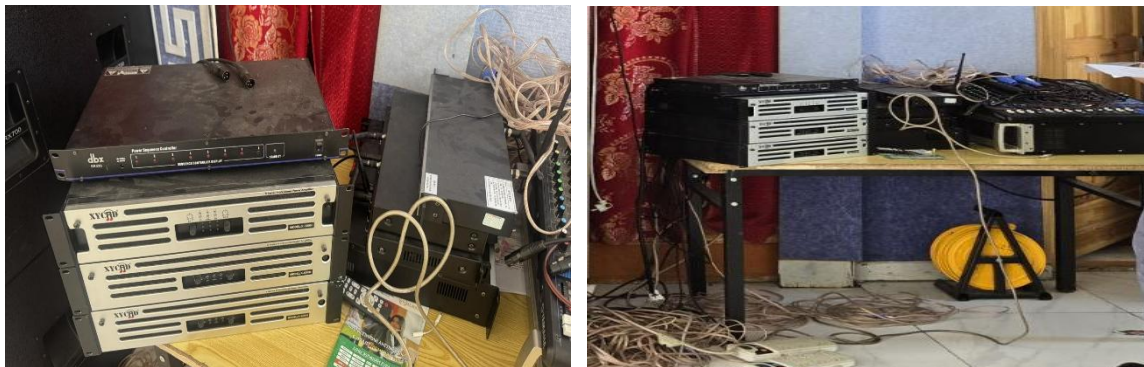
Зураг 3 Ашиглагдахгүй байгаа тоног төхөөрөмж
