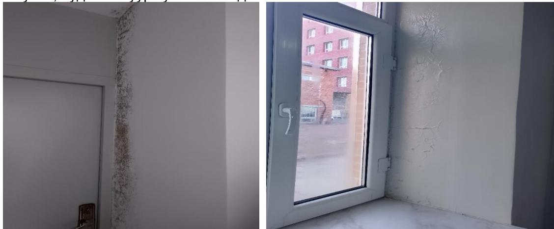
Нэгдсэн эмнэлгийн угаалгын байрны мөөгөнцөр үүсэж, будаг нь хуурсан байдал
