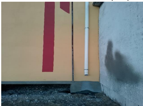
Хатгал тосгоны Ерөнхий боловсролын бага сургуулийн засвар, дулаалгын ажлыг гүйцэтгэхдээ газардуулгыг таслаад эргэж холбоогүй байдал
