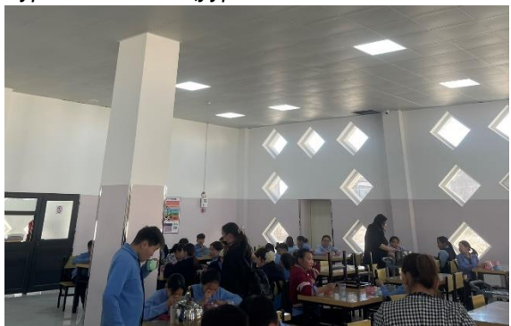
Зураг 5 Хананд цууралт өгсөн байдал
