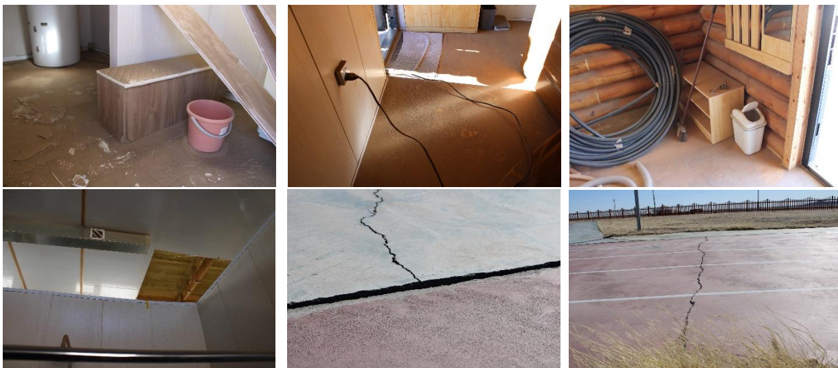
Хүүхдийн зуслангийн барилга, байгууламж, зам, талбай, гаднах тохижилтод үүссэн эвдрэл, гэмтэл
