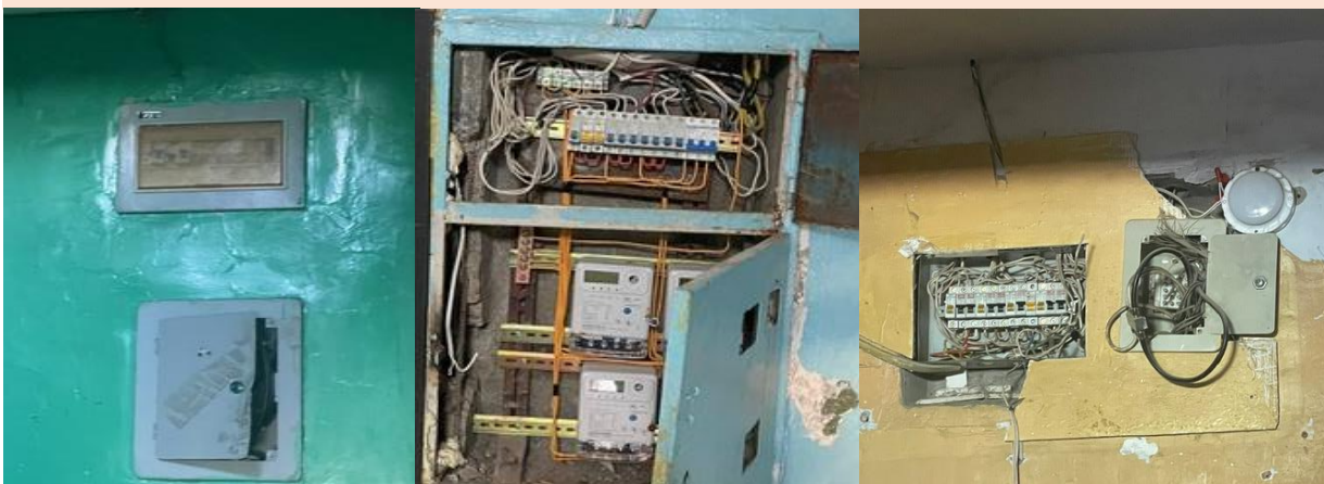
Зураг №1: Ажлын тоо хэмжээнээс дутуу хийгдсэн 2,3,6-р байрны цахилгааны самбар, монтаж /100 самбар/
