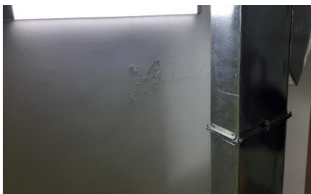
Барилгын дээврээс ус дотогш нэвчсэн
