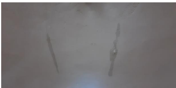
Барилгын дээврээс ус дотогш нэвчиж гоожсон
