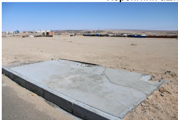
Зураг №9 Сайншанд сумын “Автобусны буудал шинээр байгуулах ажил” 1 автобусны буудлыг автомашин мөргөж эвдэлсэн /аудитын явцад засварласан/ /2022.05.06-ны өдрийн байдлаар/
